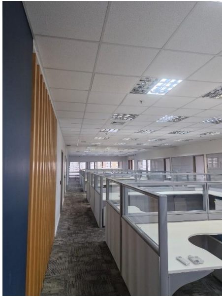
Foto 9: Luminárias em todo o andar para quatro lâmpadas com 2 lâmpadas instaladas.
