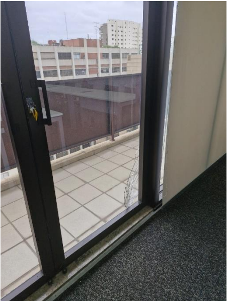
Foto 11: Vidro da sacaca do conjunto 1203 trincado.
