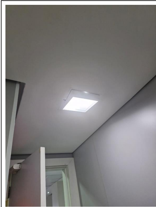
Foto 13: Luminária no sanitário feminino no conjunto 1202 solta.
