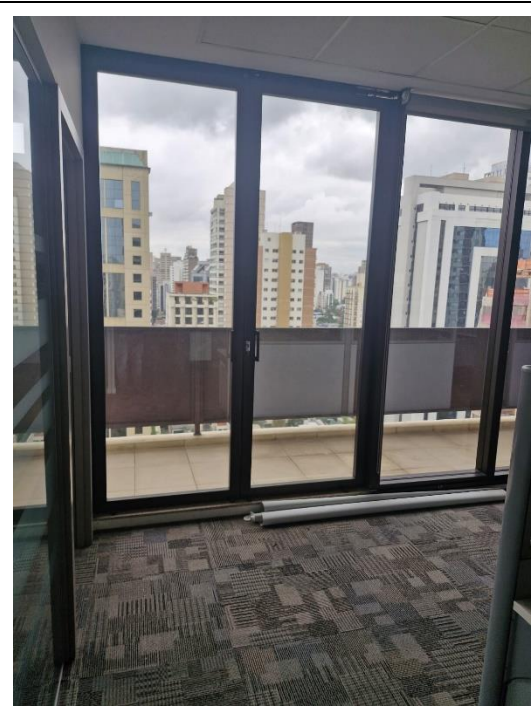
Foto 14: Persiana da sacada do conjunto 1203 desinstalada.
