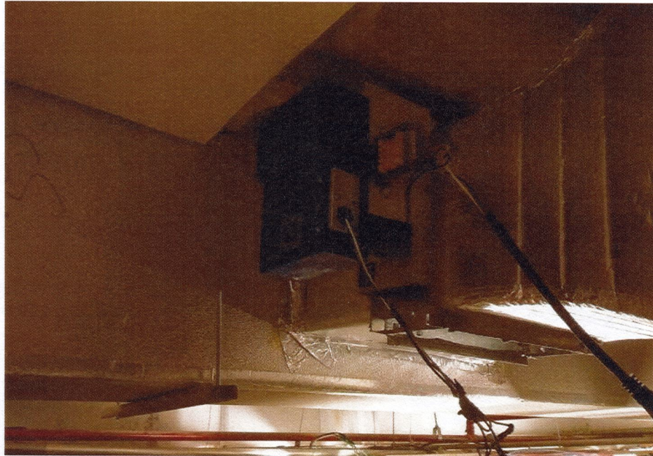
Foto 51. 16º andar | Atuador Cibracon - Instalado em série após a caixa VAV 02 do Condomínio.
