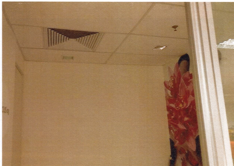
Foto 52. 16º andar | VAV 01 - Sala Focus 03 - Sem sensor de temperatura e sem detector de incêndio.
