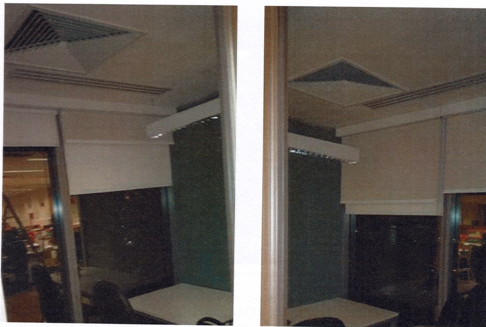
Foto 48. 15º andar | Salas Focus - Sem Sistema de Detecção e Alarmes de Incêndio.
