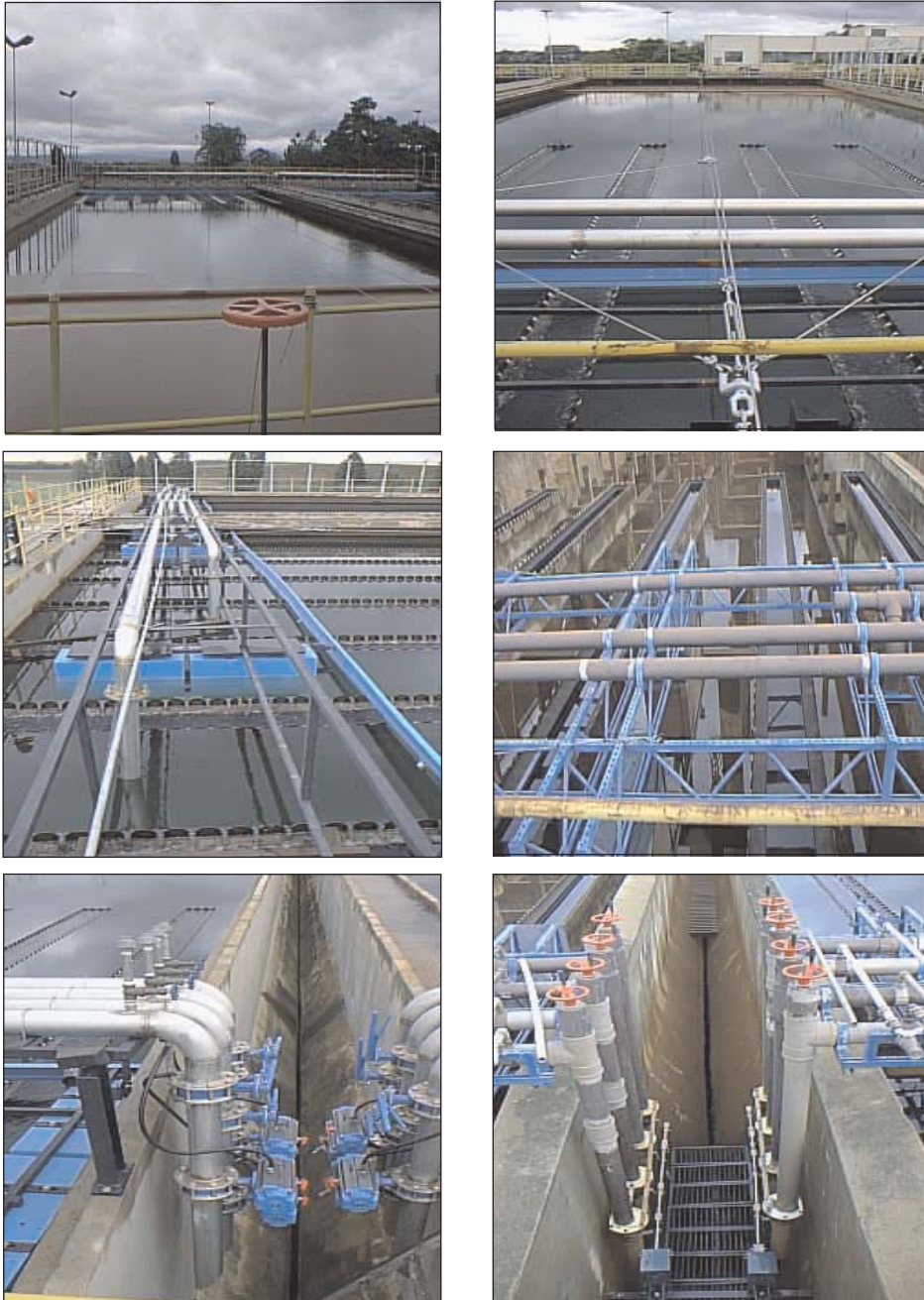
Figura 8.2 Fotos ilustrando equipamento de sifão flutuante móvel para remoção de lodo de decantador convencional.
