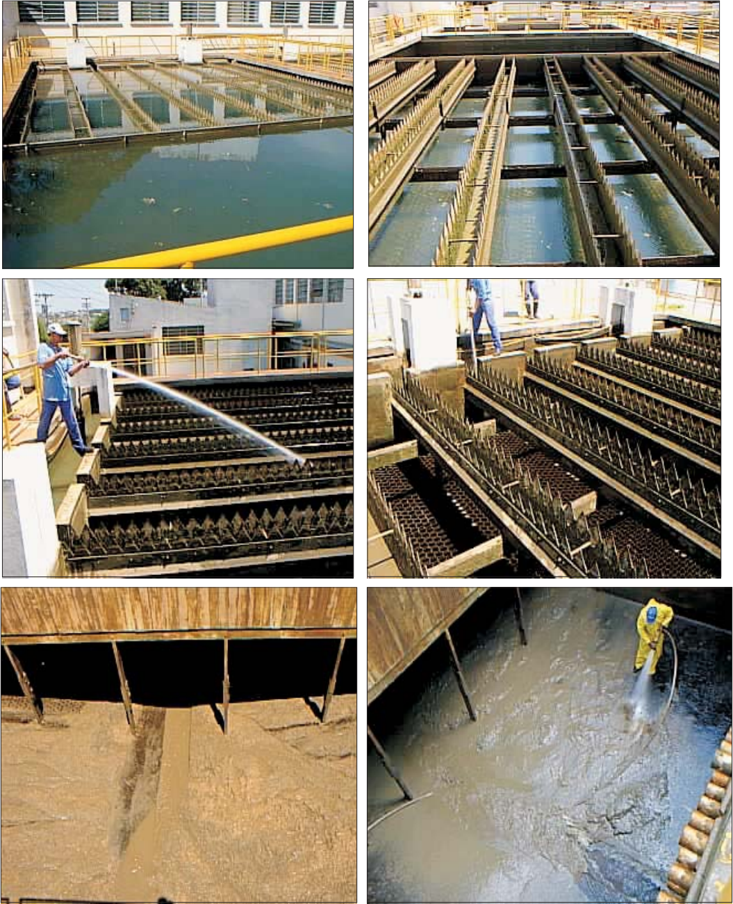
Figura 8.3 Fotos ilustrando decantador convencional transformado em decantador de alta taxa, com limpeza manual.
