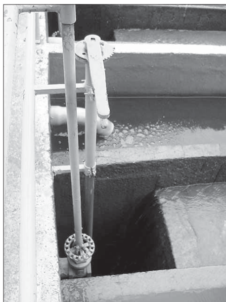
Figura 8.29 Saída da água de lavagem dos filtros descendentes.
