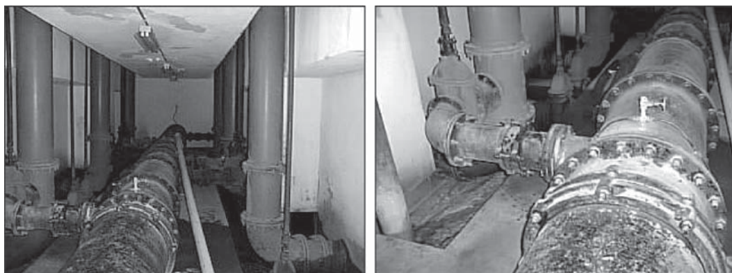
Figura 7.62 Tubulação geral de alimentação dos filtros ascendentes a partir de uma câmara de carga única.
