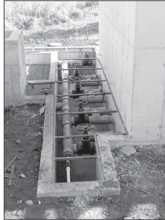
Galeria de tubulações dos filtros (1)
