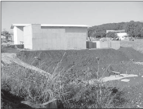
Vista geral da ETA, câmara de contato e leitos de secagem
