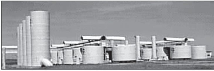
a) Vista geral da instalação de dupla filtração
