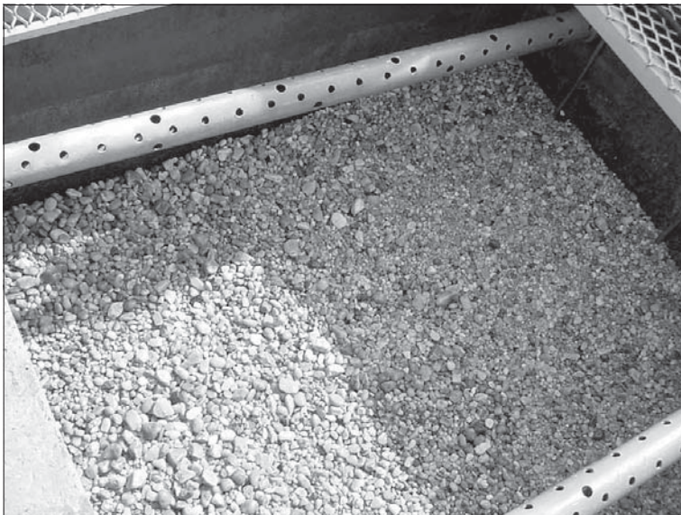
Figura 8.35 Aspecto da camada de pedregulho após a operação de lavagem com ar e descarga de fundo.
