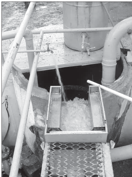
Figura 8.31 Poço de sucção e entrada de água filtrada.
