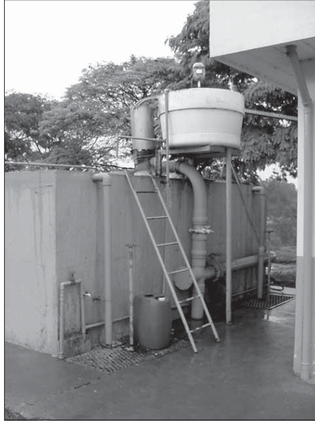
Figura 8.26 Chegada de água bruta e sistema de preparação e dosagem de polieletrólito.
