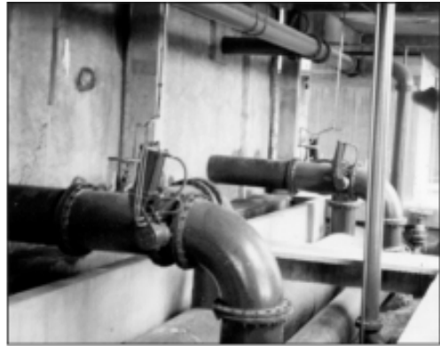
b) Tubulações individuais de saída conectadas a uma tubulação geral de água filtrada interligada a uma caixa com vertedor
