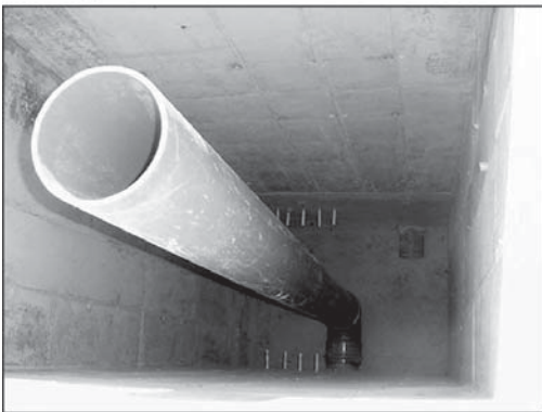
Câmara de carga e tubulação de alimentação dos filtros ascendentes
