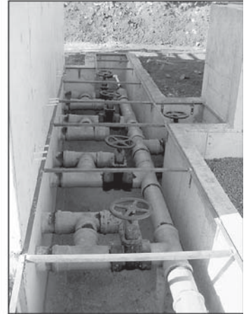
Galeria de tubulações dos filtros (2)
