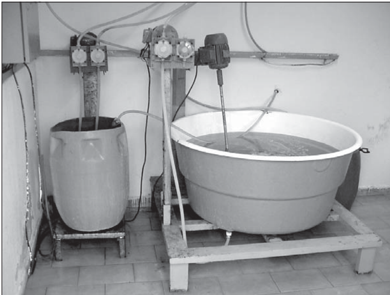
Figura 8.25 Sistema de dosagem de PAC e hipoclorito de sódio.
