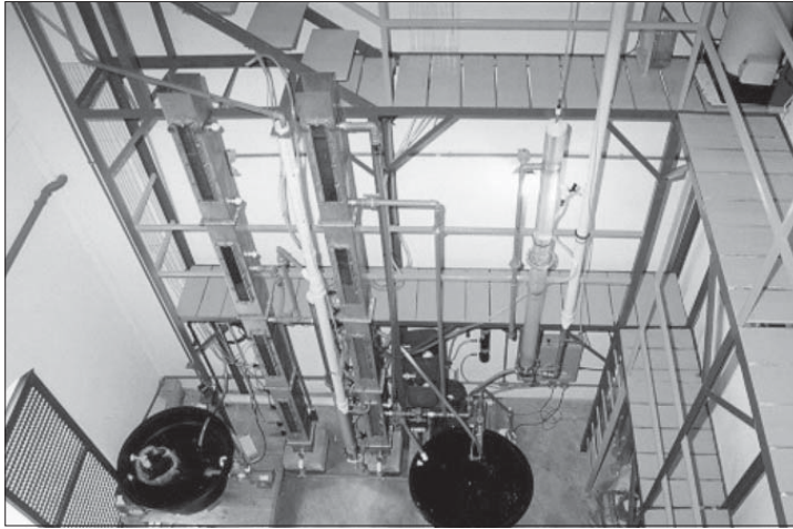
Figura 4.21 Vista dos filtros (esq.) e do floculador granular (dir.) da instalação-piloto da UFSC.
