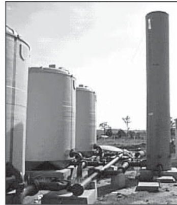
Câmara de carga e tubulação geral de alimentação dos filtros
