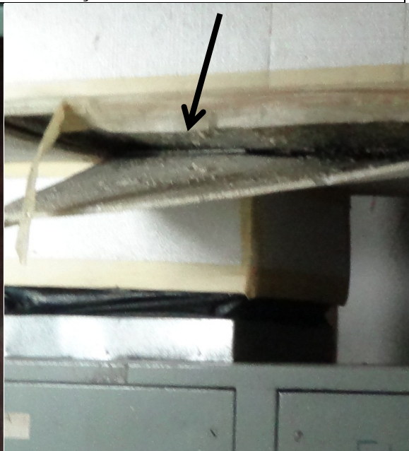
7º Pavimento - Isolamento térmico comprometido
