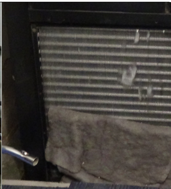
6º Pavimento - Necessidade de substituição da lã de vidro
