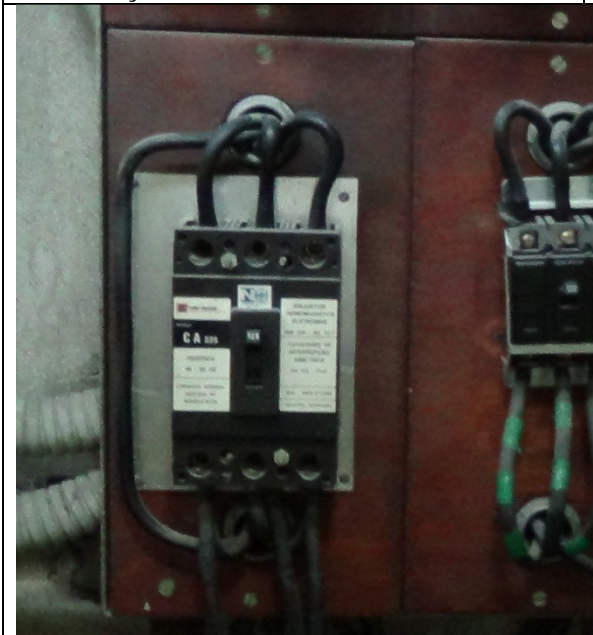
3º Pavimento - Contatos vivos dos disjuntores sem proteção
