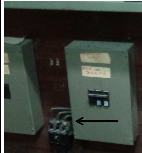
7º Pavimento – Contatos vivos dos disjuntores sem proteção
