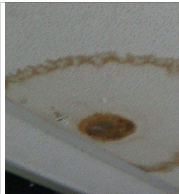
9º Pavimento – Umidade no teto
