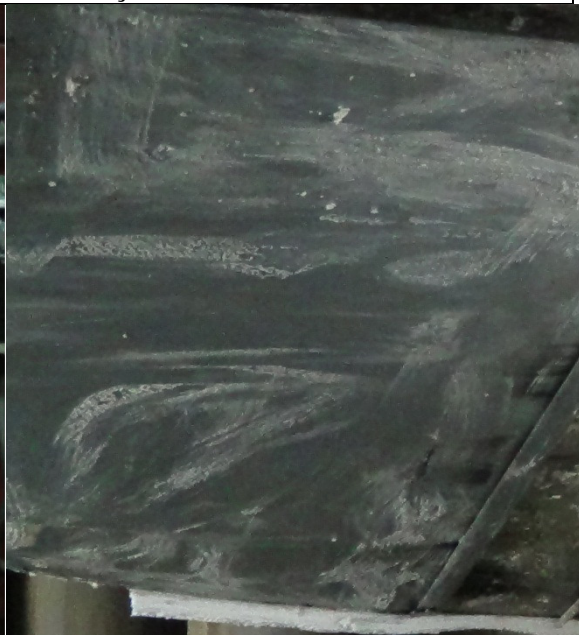
3º Pavimento - Isolamento térmico comprometido
