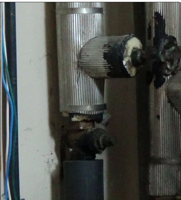
8º Pavimento – Necessidade de substituição do isolamento térmico
